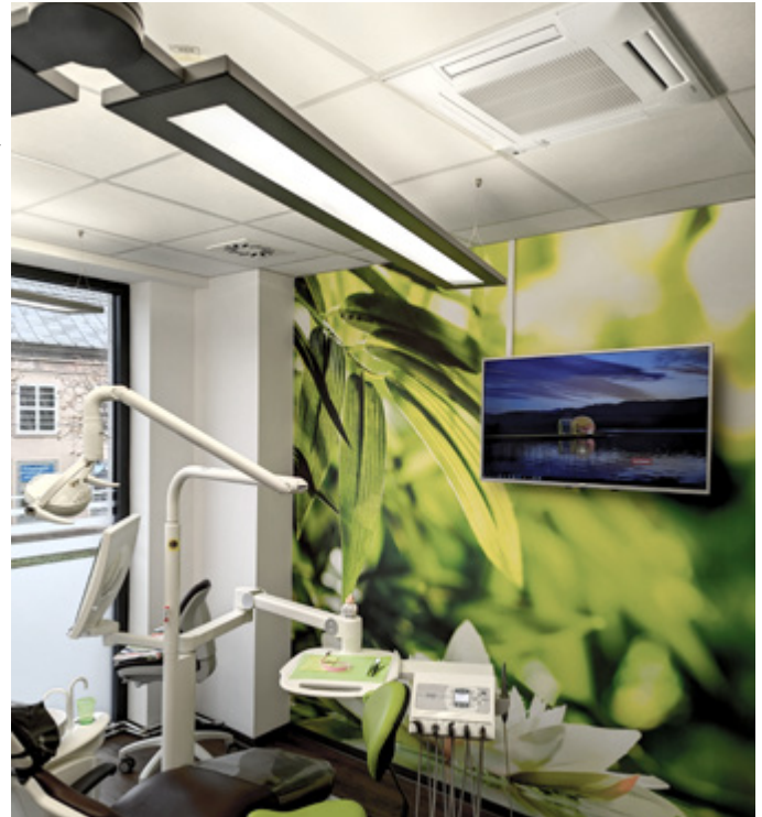
Kassettengeräte von Hitachi zur Temperierung der Behandlungsräume
